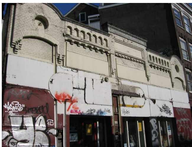
Fig. 9: De staat van het pand in juni 2008. Foto: auteur.
